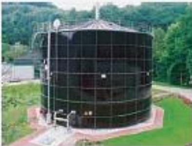
Tanque Contenedor de Gas - Alemania
