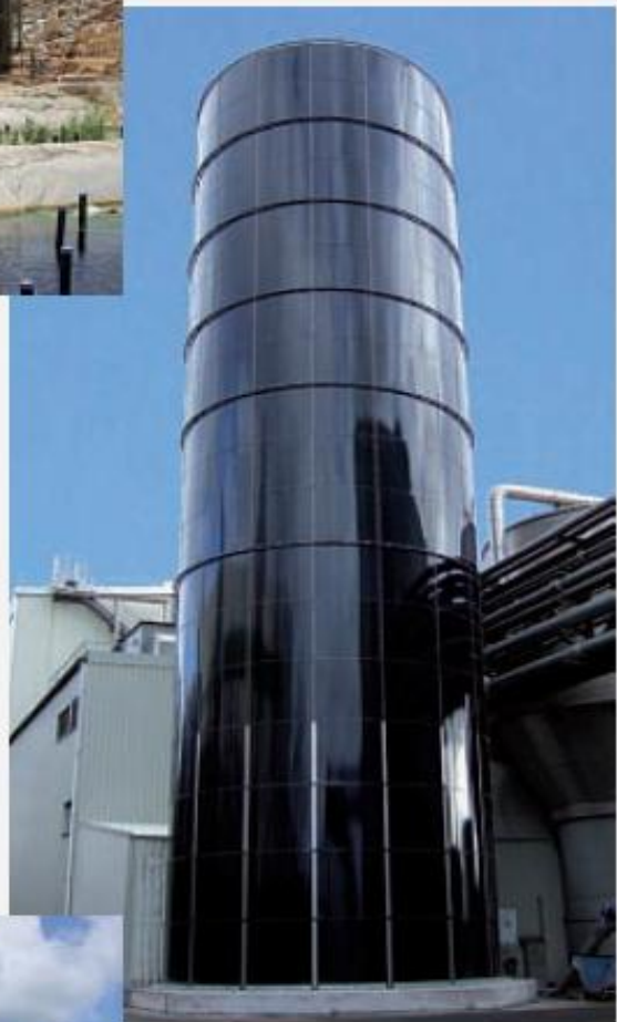
Tanque de Agua Residual - Alemania
