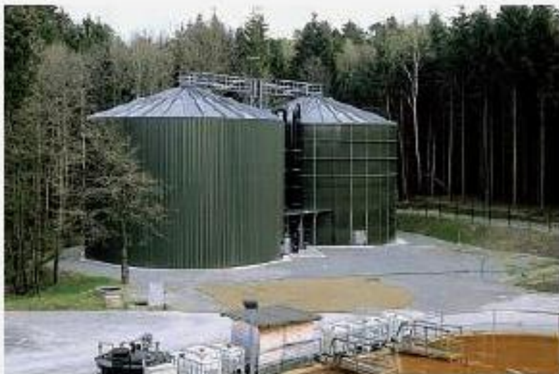
Tanques de Agua Residual - Alemania
