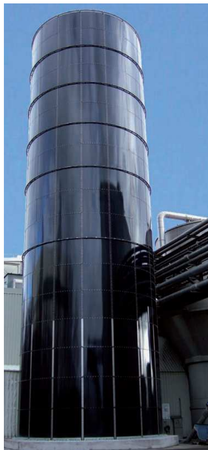
Водосборник технической воды
