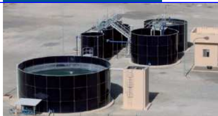
Очистные сооружения, Оман
